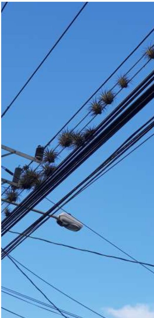
1 Tillandsien auf einem Strommast
